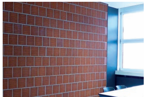
Akustik-Ziegelwände in einem Unterrichtsraum zur Verbesserung der Raumakustik durch Reduzierung der Nachhallzeit
