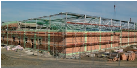
Industriehalle in Skelettbauweise mit Stützen und Riegeln aus Stahlbeton und Ausfachungen aus Wärmedämmziegeln
